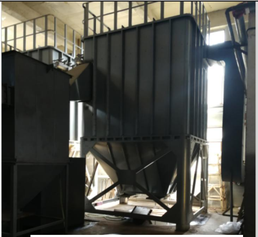
锅炉布袋除尘器
