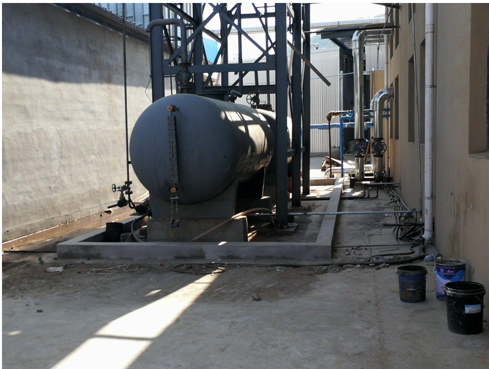
导热油罐区围宴
